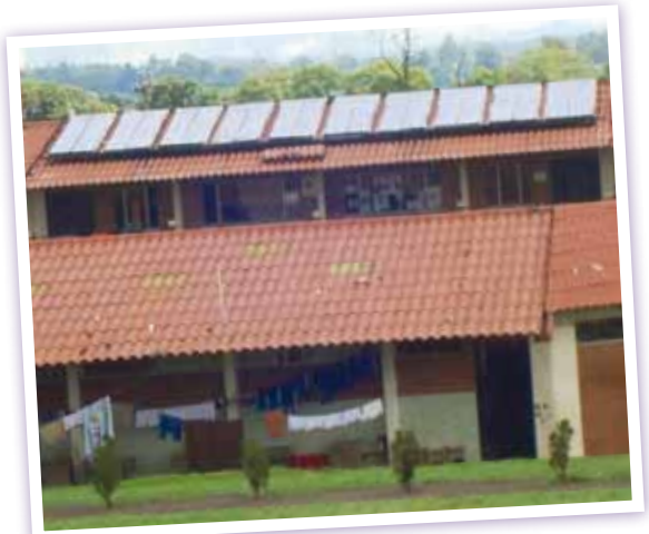
Sonnenkollektoren dienen der Wassererwärmung
