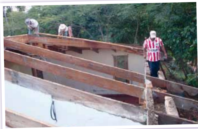
Immer wieder müssen Dächer repariert werden – auch wegen der Sicherheit für die Kinder
